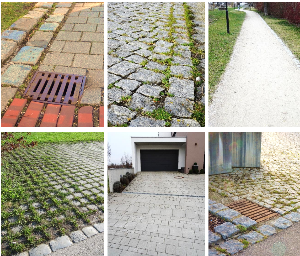
Abb. 4: Auf gepflasterten und anderweitig befestigten Flächen ist die Anwendung von Pflanzenschutzmitteln grundsätzlich verboten (Fotos: Jakob Maier, LfL).
