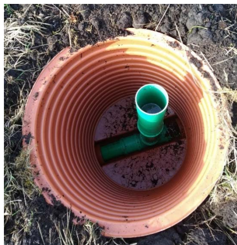
Abbildung 20: Ein Kunststoffschacht bestehend aus einem Schachtrohr und Steigrohr zur Regulierung des stromaufwärts gelegenen Flächenwasserstandes.
