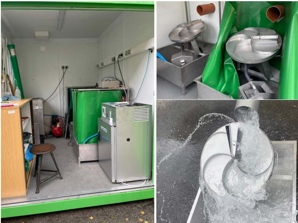
Mit Messtechnik ausgerüsteter Container (links), eingebaute Coshocton-Räder (rechts oben), Coshocton-Rad im Praxistest (rechts unten)
