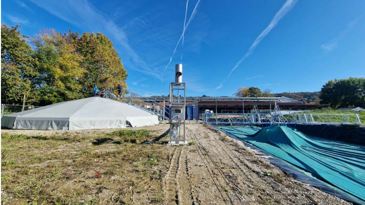
Ansicht der Pilot-Biogasanlage am Agrarbildungszentrum Landshut-Schönbrunn mit textilem Fermenter mit Gashaube und Steg (linke Bildhälfte), Erdbecken mit Nachfermenter und Rohrleitungsbrücke (rechte Bildhälfte), Notfackel (Bildmitte im Vordergrund).
