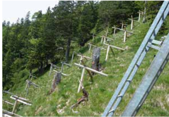
Abbildung 2: Hangschutzverbauung in den Alpen
