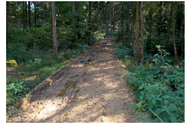
Einen Bachlauf querende, ständig feuchte Rückewegetrasse.
