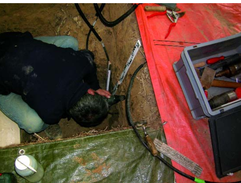
Einbau der Bodenfeuchtesensoren; Operation am Bodenprofil mit optimierten Verfahrensschritten zur Vermeidung von negativen Folgen des Eingriffs. (Foto: W. Grimmeisen)
