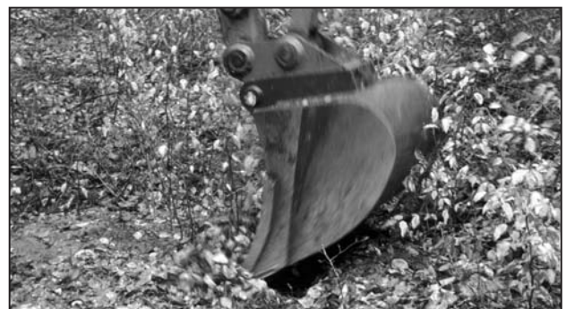
Abb. 2: Der Baggerfahrer setzt den Tieflöffel leicht schräg nach unten geneigt an und bewegt ihn in die Tiefe und gleichzeitig zu sich hin.
