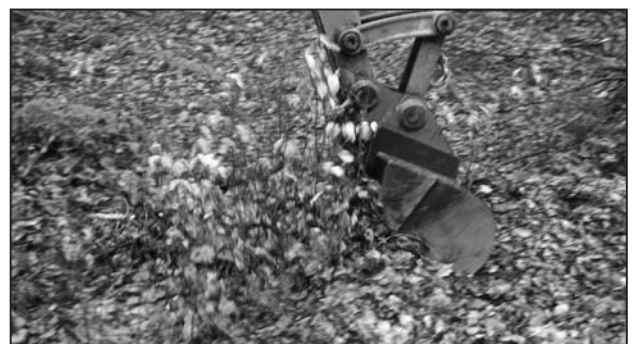
Abb. 3: Sobald der Löffel „gefüllt“ ist, hebt der Baggerfahrer den Tieflöffel vorsichtig nach hinten aus. Dadurch gleitet der gelockerte Erdbereich wieder in seine Ausgangslage zurück. Die Wildlinge stehen wieder überwiegend gerade.
