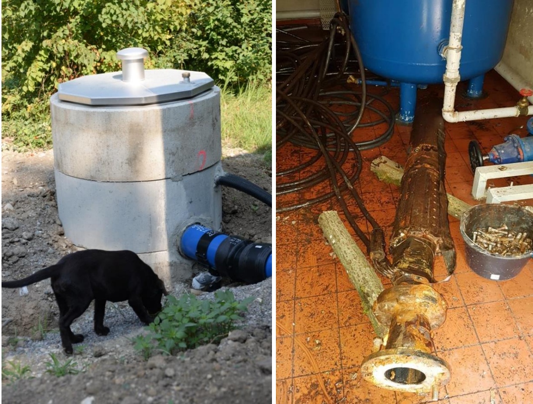
Abbildung 2: Brunnen (l) und Tauchpumpe (r) zur Entnahme von Grundwasser.
