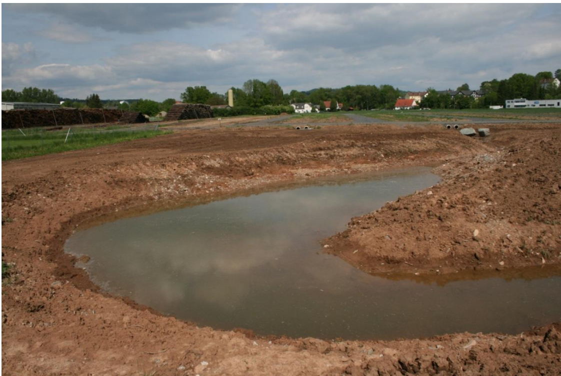
Abbildung 8: Geregelter Abfluss über Grabensysteme. Der Platzbedarf ist bei der Planung zu berücksichtigen, ebenso ggf. notwendige Versickerungs- oder Klärflächen mit Schilf.
