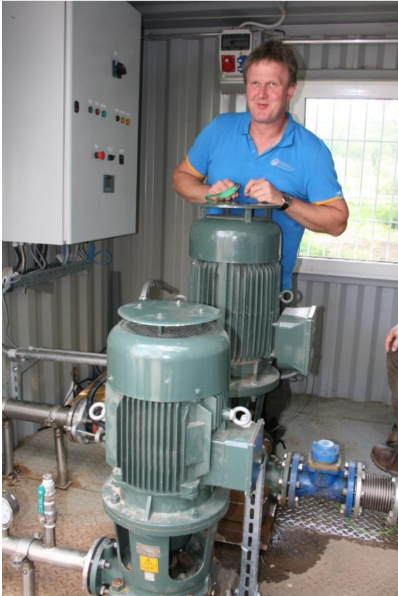
Abbildung 4: Saugpumpen mit Steuerungskasten.
