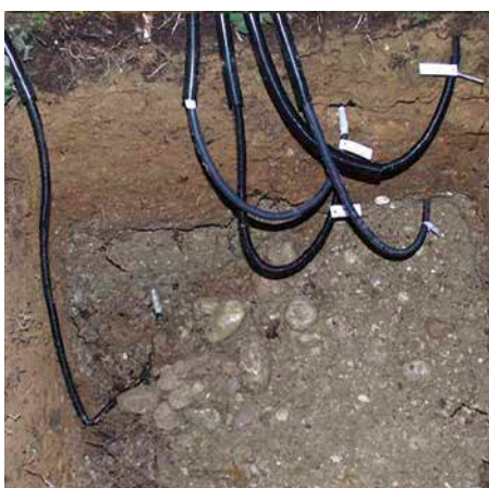
9 In einem Datenloggerkasten (oben) werden die Messwerte der Bodentemperatur und -feuchtigkeit gesammelt und abgespeichert. Die Sensoren werden in verschiedenen Bodentiefen eingebaut (unten). Nach dem Einbau wird das Bodenprofil wieder verfüllt. Foto: H.-J. Krause, LWF
