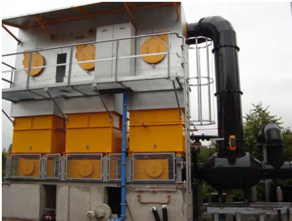
Abb. 2: Regenerative Nachverbrennungsanlage nach einer Biogasaufbereitung
