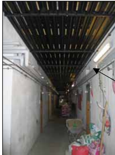
Abb. 20: Kühldecke und unterhalb liegende Zuluftöffnungen (Pfeil) in die Stallabteile
