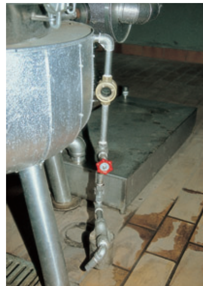
Abbildung 15: Kondensat-Rückfluß-Kontrolle an der Versuchsanlage
