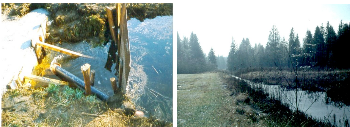
Fertigstellung des Ablaufes mit einbetoniertem Kunststoffrohr (Bild links), der aufgestaute Hauptgraben im Winter 2002/2003 bei normalem Wasserstand (Bild rechts)
