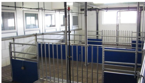
Mastabteil mit Schadgasmessung
